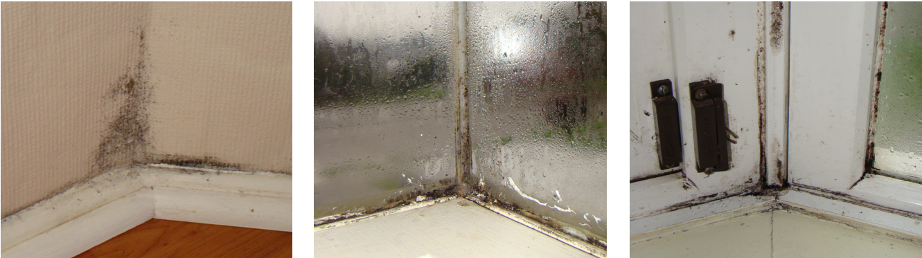
Imagen 5. Hongos en ventana y muro orientados al sur, vivienda construida bajo norma térmica del 2000
